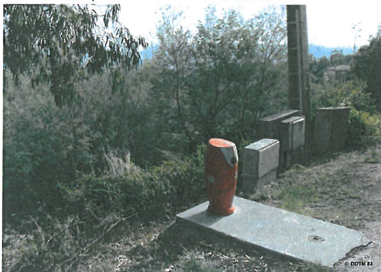
Poteau incendie sur la RD41 au-dessus du village de Bormes-les-Mimosas.
